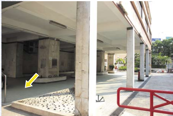
大廈出入口，有天花板但沒有圍封。
